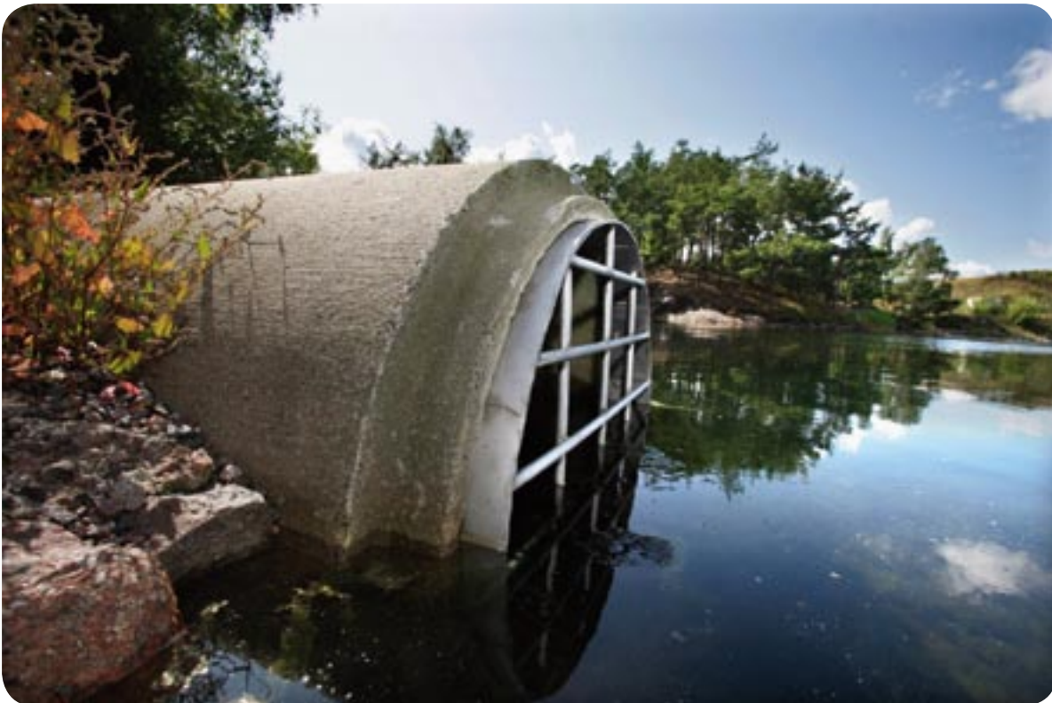
Figur 8-6. Utsläppsrör från reningsverket vid Hamnefjärden.
