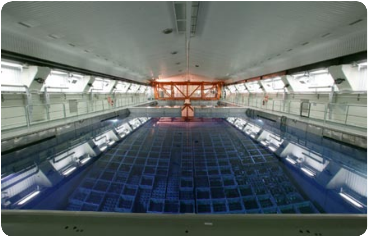
Figur 8-7. Förvaringsbassäng i Clab.
