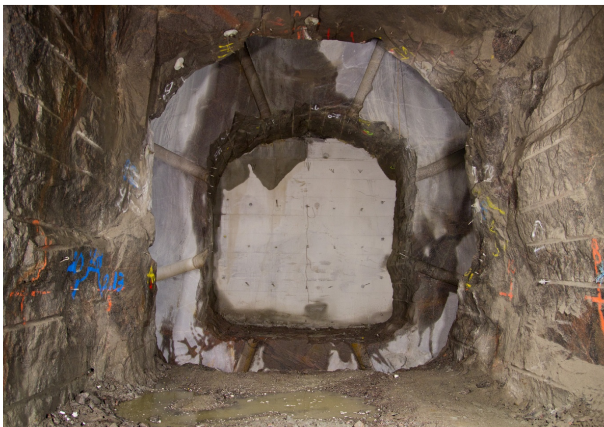
Figur A-2. Bild ifrån slitsuttag med vajersågning från Äspö HRL (Hard Rock Laboratory).
