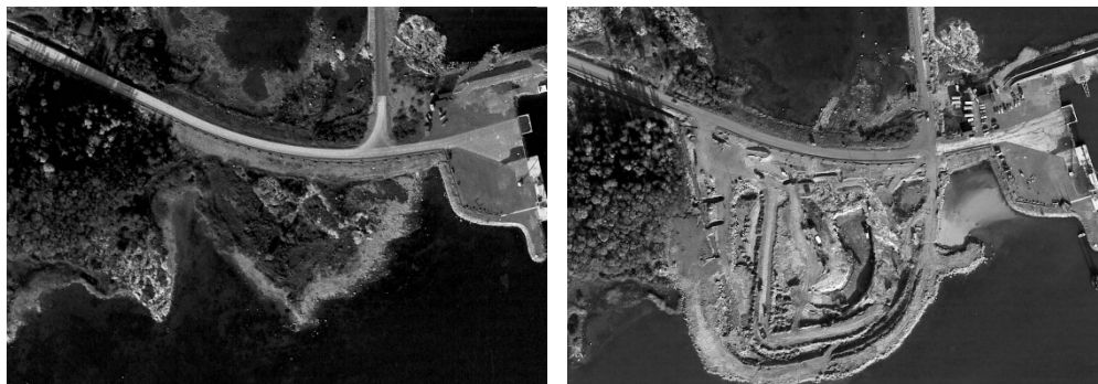
Figur 3. Bilder från uppförandet av den befintliga SFR-anläggningen. Bilden till vänster visar Stora Asphällan oktober 1982, bilden till höger visar samma område oktober 1983.
