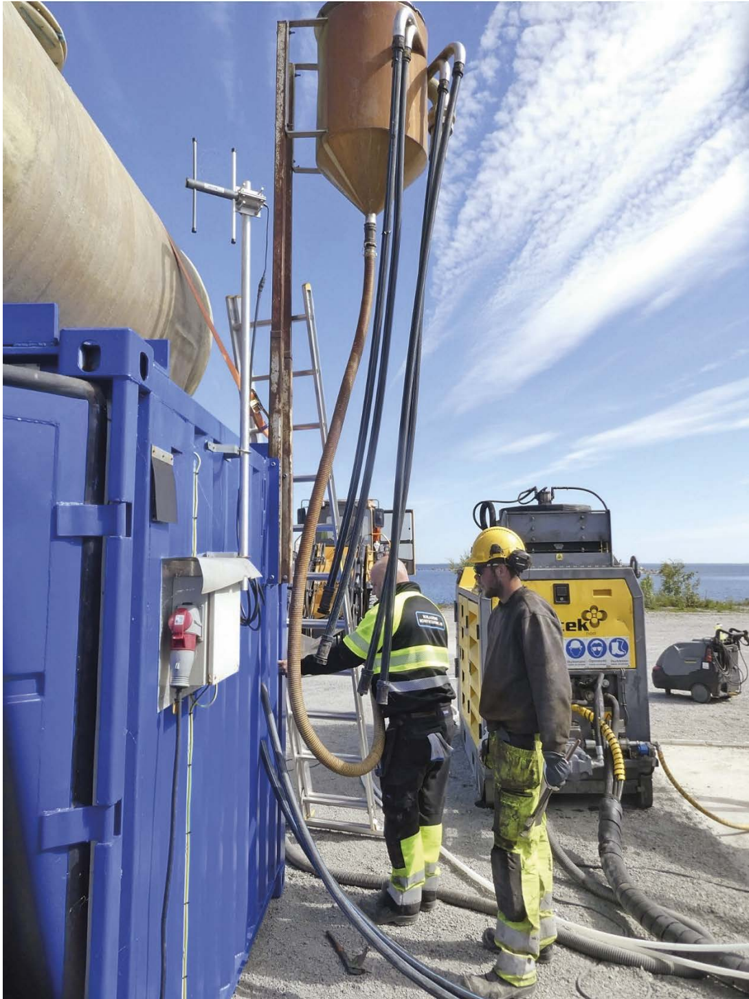
Figur 4-10. I mätcontainern finns flödesmätare som registrerar volymen både för ingående vattnet (som körs till borrhålet med tankvagn) och för returvattnet som pumpas upp ur borrhålet. På bilden ansluts alla slangarna till rätt uttag.
