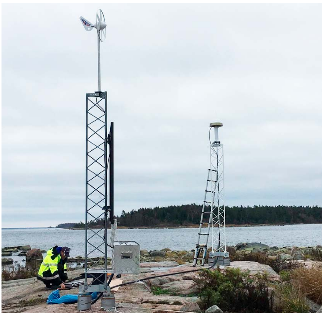
Figur 3-2. Referensstation Lillkobben (LKBB.0). Till vänster fackverksmast med sol-, och vindkraft samt övrig teknisk utrustning i aluminiumskåp. Till höger fackverksmast med GNSS-antenn. Foto: Rickard Jäderberg.
