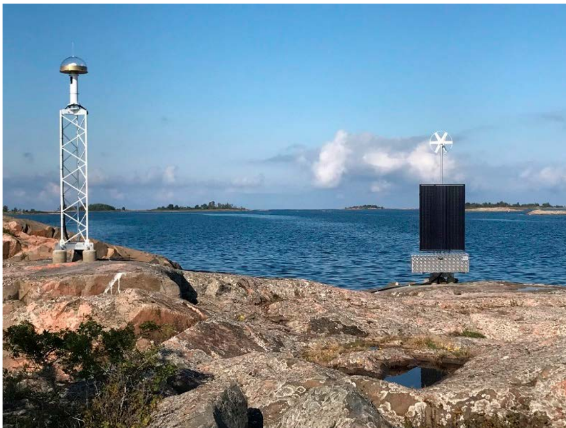
Figur 3-5. Referensstation Västra Måsklinten (VMAS.0). Till vänster fackverksmast med GNSS-antenn. Till höger sitter sol-, och vindkraft samt övrig teknisk utrustning i aluminiumskåp. Foto: Hans-Åke Åström
