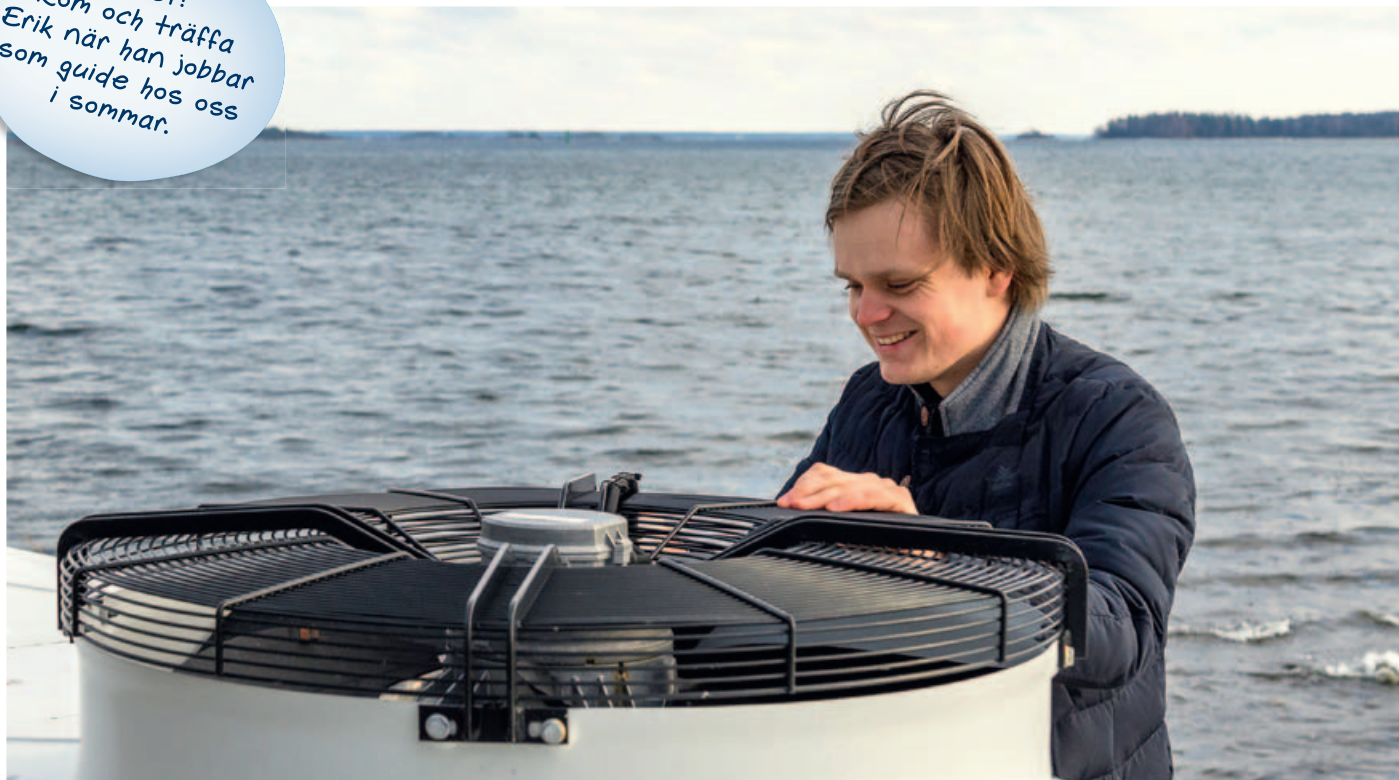
En del av kylanläggningen utanför Vegakontoret får en liten koll av Erik Wendin som gör sitt examensarbete på SKB.
