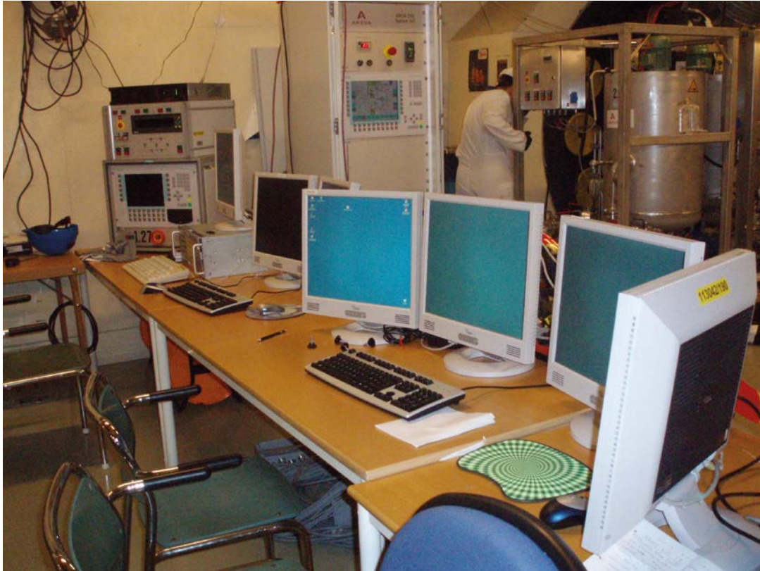
Figur 3-24. AMDA kontrollrum utanför RI.
