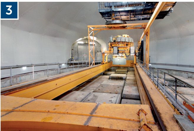
3 Avfallskollina förs med travers till silotoppen. Silon är indelad i fack där kollina sänks ner.
