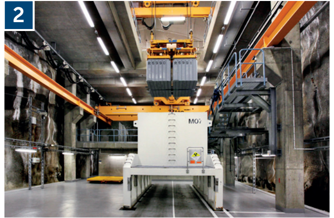
2 Här sker urlastning från transportbehållaren. Innan locket lyfts av skannas behållaren för att upptäcka eventuella radioaktiva ämnen.
