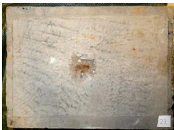
Figur 4-4. Anläggningsbetong med ingjutna klorider (Sederholm et al. 2014).
