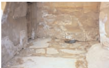
Fukt- och saltskador på templen.
