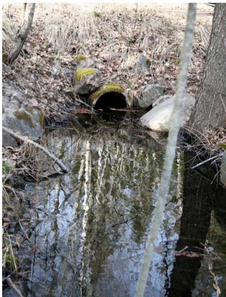
Figur 5-2. Tjärnpussens nuvarande utlopp i dess norra del (se översiktskartan i figur 1-1). Utloppet består av en betongtrumma (som utgör tröskel) under en gång- och cykelväg.
