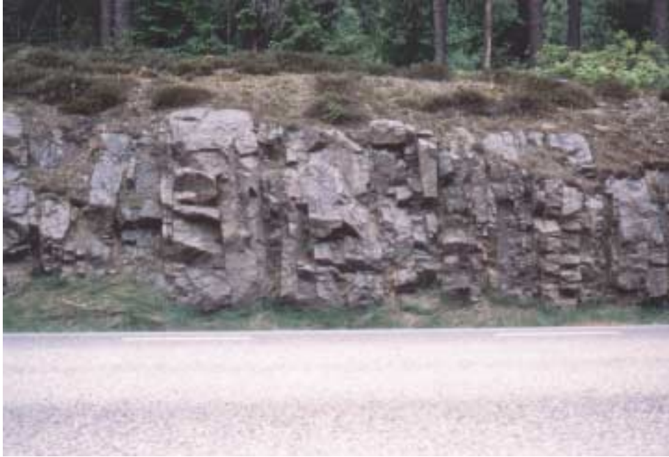
c) Lokal kraftig uppsprickning. Samma vägsränning som i Figur 9b (RAK 6372482/1501833).
