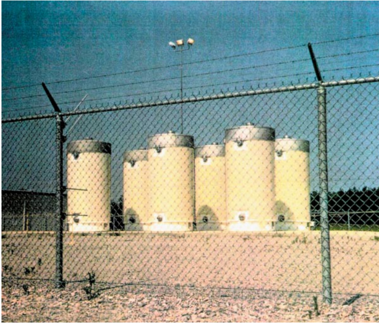
Figur 2-1. Utomhuslagring vid ett kärnkraftverk.
